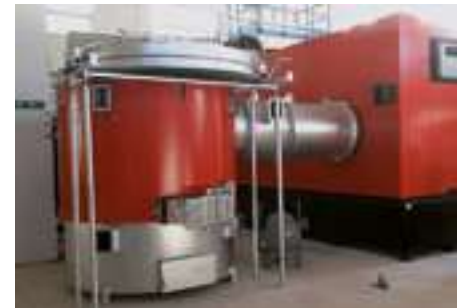
2,5 MW (thermal) plant with ORC turbines generating 220 kW (electrical) - started in July 2017 in Torrenova, Italy. Centrale 2,5 MWth avec turbines ORC produisant 220 kWe – démarrée en juillet 2017, Torrenova, Italie.
