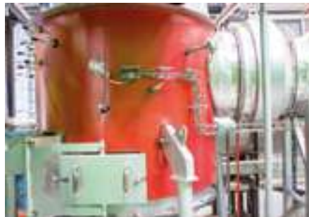
550 kW (thermal) plant with an ORC turbine - started in August 2017 in Hyères, France. Centrale 550 kWth avec turbine ORC – démarrée en août 2017, Hyères, France.
