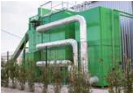
750 kW (thermal) plant with an Organic Rankine Cycle (ORC) turbine and a dryer - started in February 2016 in Hyères, France. Centrale 750 kWth avec turbine ORC et sécheur – démarrée en février 2016, Hyères, France.
